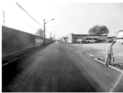
市政所施工人员经前期现场考察发现,京昆线以南路段道路病害最为严重,有长约100米范围内的道路路面坑槽极多,怀疑此
